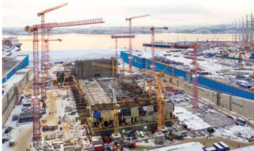
Nhà máy LNG thuộc dự án Arctic LNG. Nguồn: Novatek
